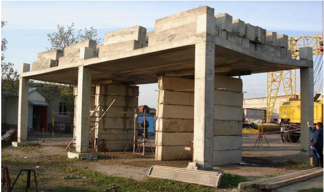
Рис.3 Общий вид разрушенного фрагмента при полной испытательной нагрузке g=11,5\text{кПа} .
